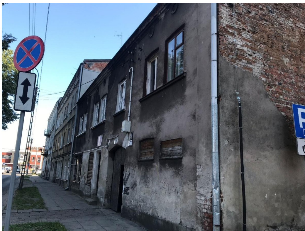
Zdjęcie 2. Kamienica wymagająca kapitalnego remontu, część okien zabita deskami
