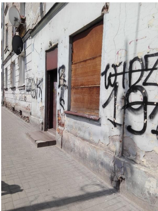
Zdjęcie 3. Niedostateczny stan elewacji budynków przy ul. Waryńskiego
